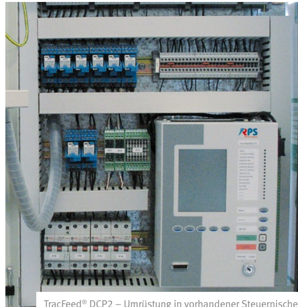
TracFeed® DCP2 – Umrüstung in vorhandener Steuernische
