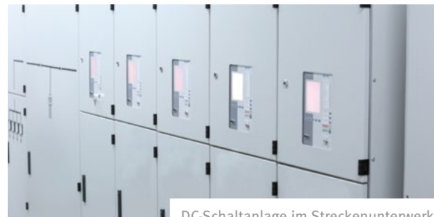
DC-Schaltanlage im Streckenunterwerk
