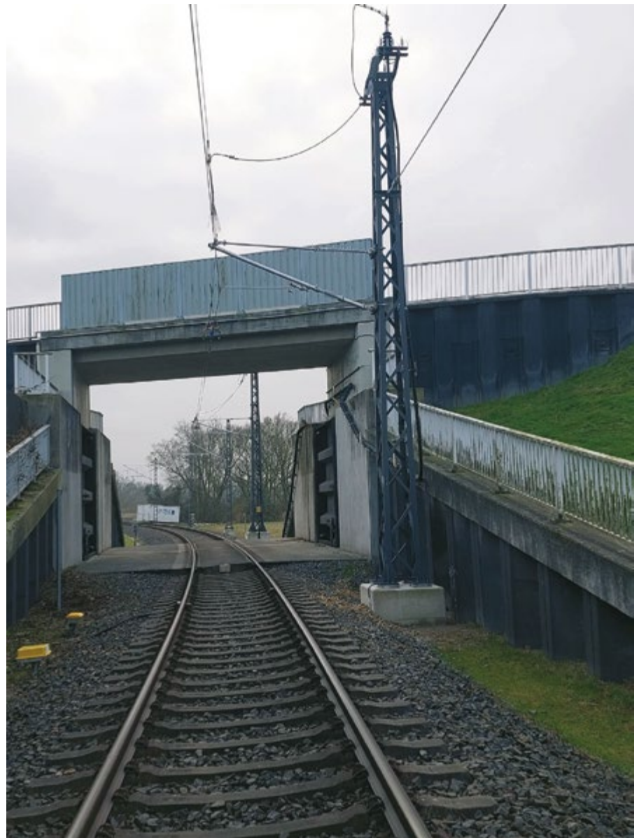
Bild 1: MS-Kabelführung am Fluttur der zweiten Deichlinie
