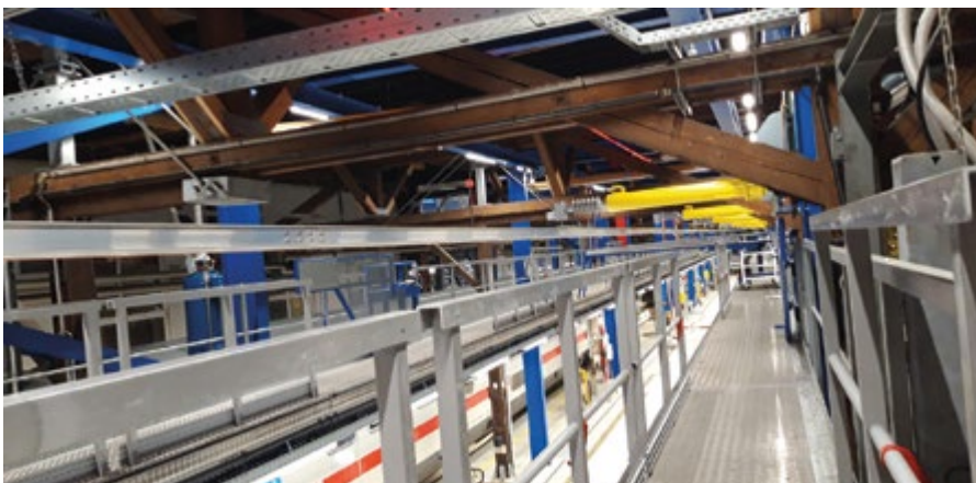
■ Bild 2: Dacharbeitsbühne mit geöffneter Segmentgrenze
